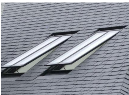
Châssis intégrés dans la pente du toit
